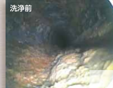
洗浄前 管径が断面縮小している
