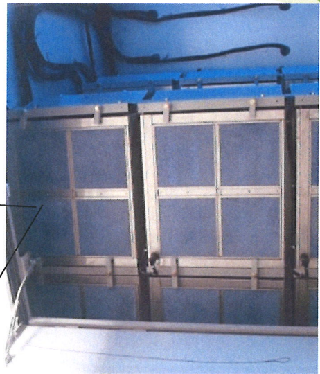
【Inside of outlet】
