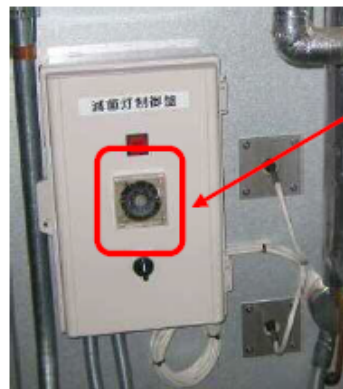
(参考事例) マスター&スレーブ制御盤の外観
