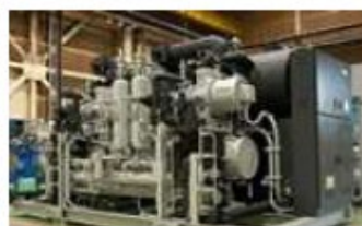
高効率冷凍機 (前川製作所)
