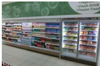
コンビニ省エネ (ローソン) 省エネ設備: パナソニック製
