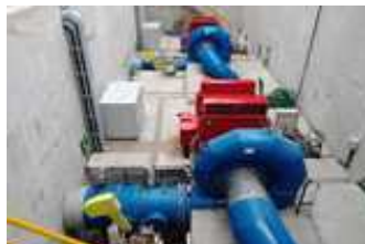
小水力発電 (トーヨーエネルギーファーム)
