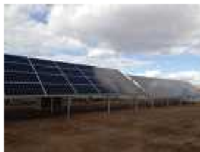
太陽光パネル
