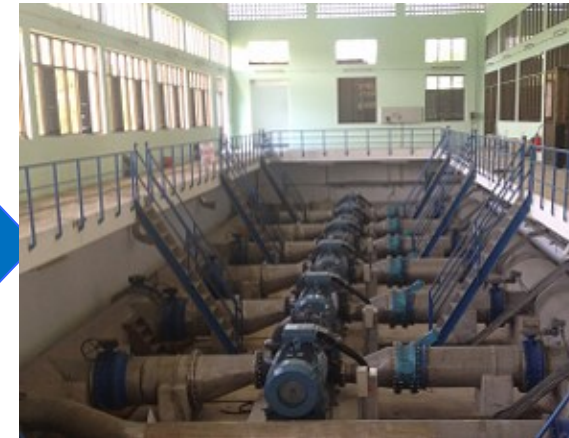
浄水場のポンプ更新事業 (二国間クレジット制度)
