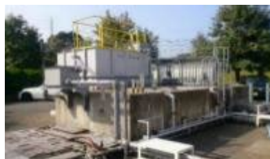
高濃度有機廃水処理
