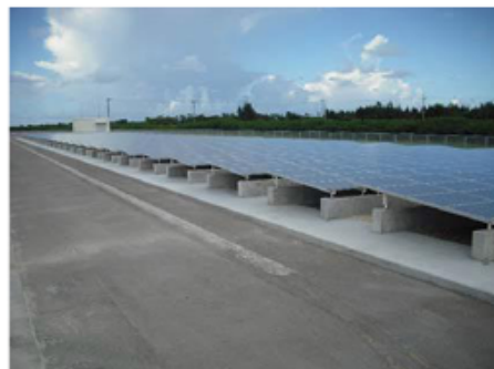
多良間島太陽光発電実証研究設備
