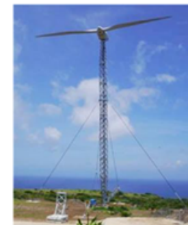
粟国可倒式風力発電設備
