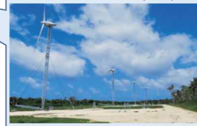
可倒式風力発電設備(トンガ)
