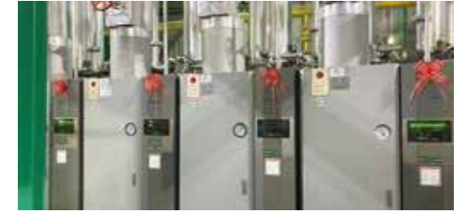
貫流ボイラー (インドネシア) DIC
