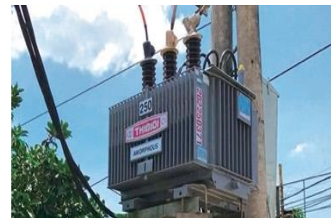
Amorphous Transformers /Yuko Keiso Co., Ltd.
