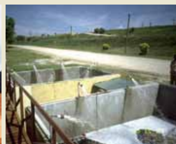
浸出水処理施設
