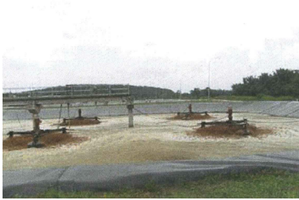
浸出水処理設備
