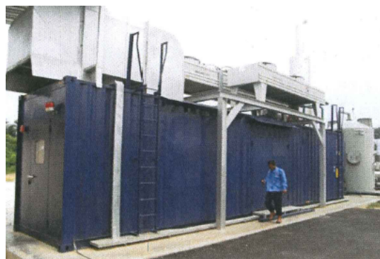
ガスエンジン
