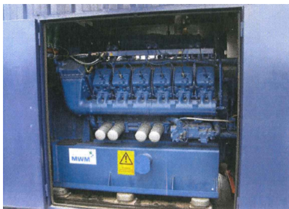
ガスエンジン
