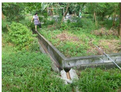
排水路 (豚舎→Biogas 施設)
