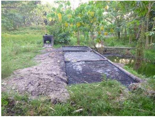
沈砂池 (左側は固体分をすくい出したもの)
