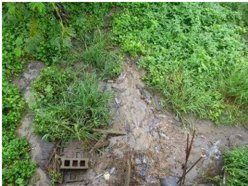
豚舎外排水路状況 (掘込みなく垂れ流し)
