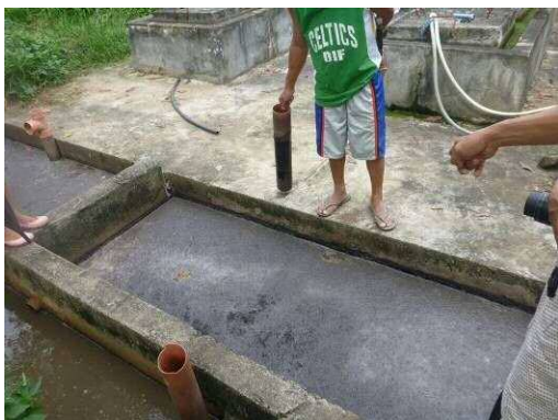
Digester 流入部 (Open)
