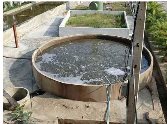
排水処理設備
