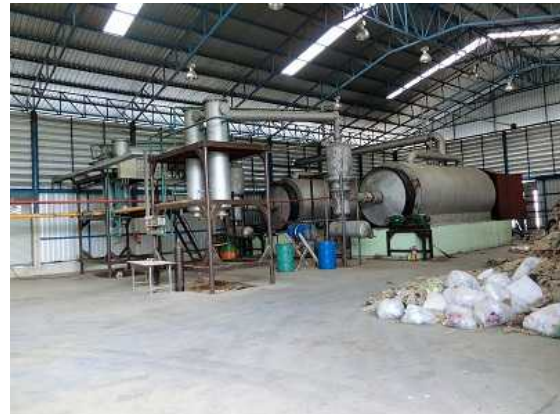
プラスチック油化プラント
