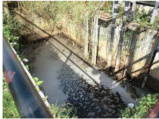
排水処理施設
