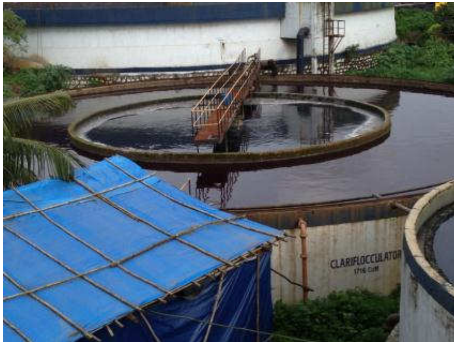
TTC CETP 濃縮槽・貯留槽
