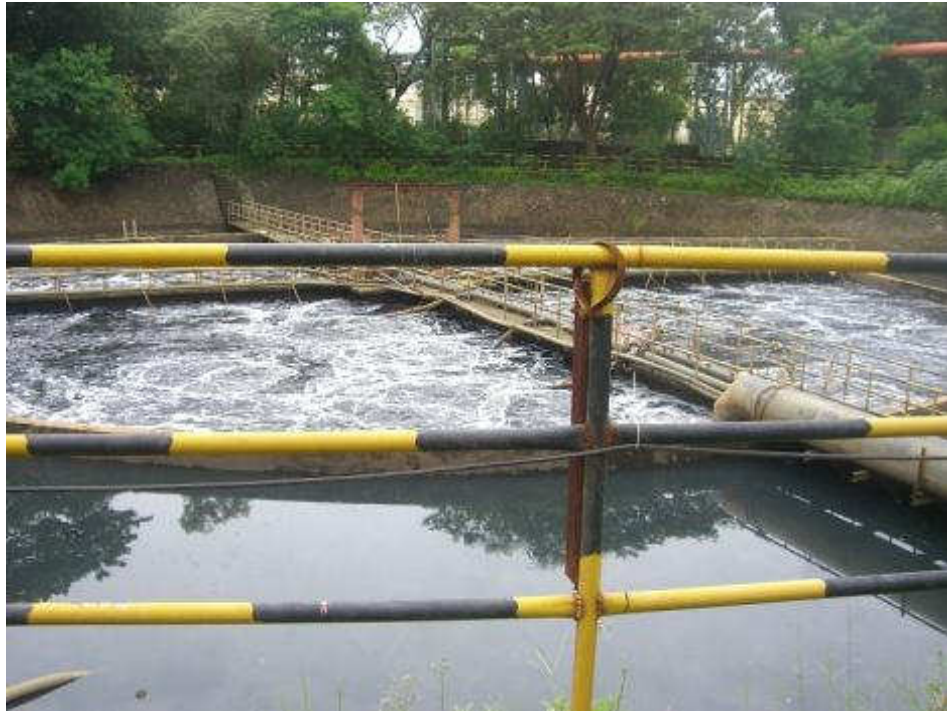
Patalganga CETP 曝氣槽
