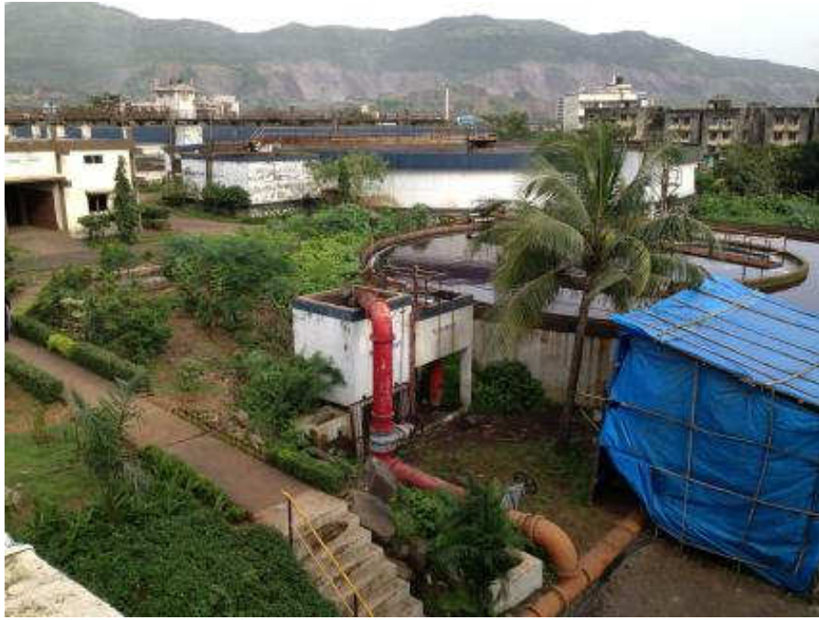
TTC CETP 沈澱池
