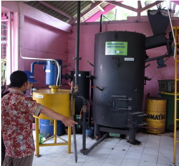
ガス発生装置全景
