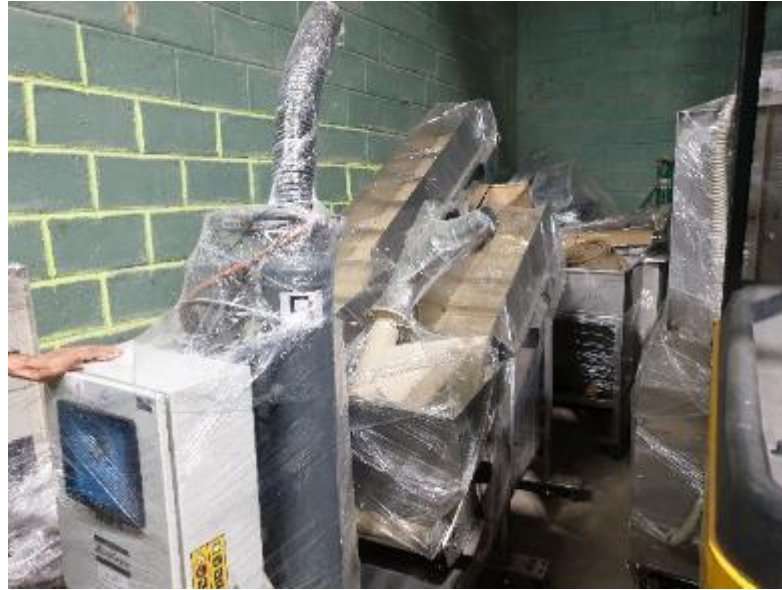
写真 3-9-1 プラスチック洗浄機
