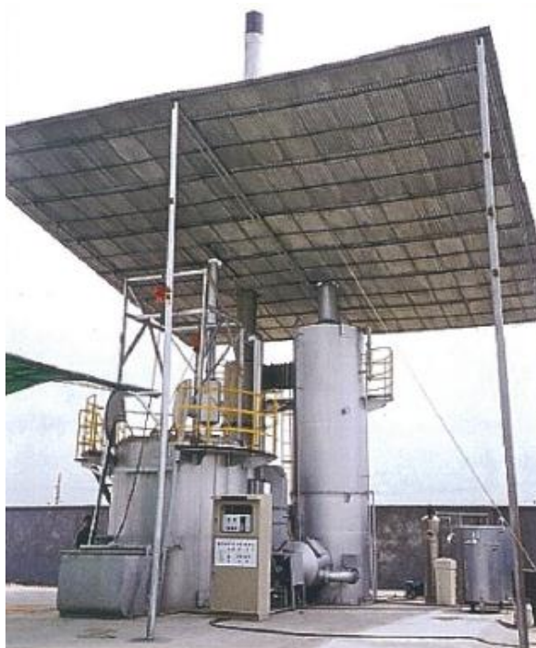
写真 3-8-1 ガス化燃焼装置
