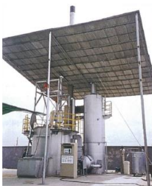
写真 2-4-2 乾溜ガス化装置
