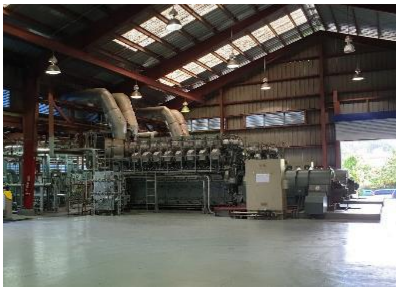
写真 4-8-1 コロール州アイライ発電所にある発電機
