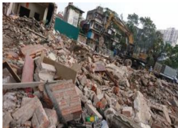
図 2-2 解体現場のレンガ (埼玉大学川本教授提供)
