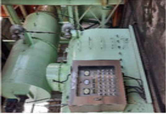
写真 8 病院 3 の焼却炉
