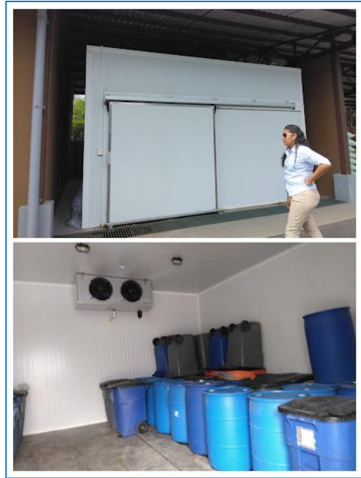
図 18-2 生ごみを保管する冷蔵庫と冷蔵庫内部
