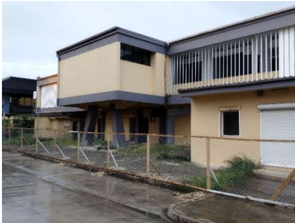
2024年12月の大地震で損壊し、 取り壊されないまま放置されている首都市内建物 (2025年4月筆者撮影)
