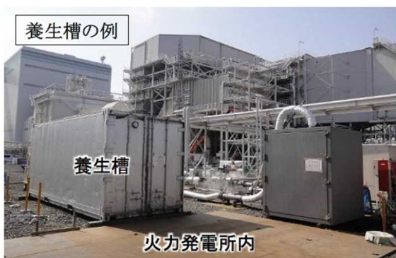
図 1.1 発電所内に設置した養生槽の例
