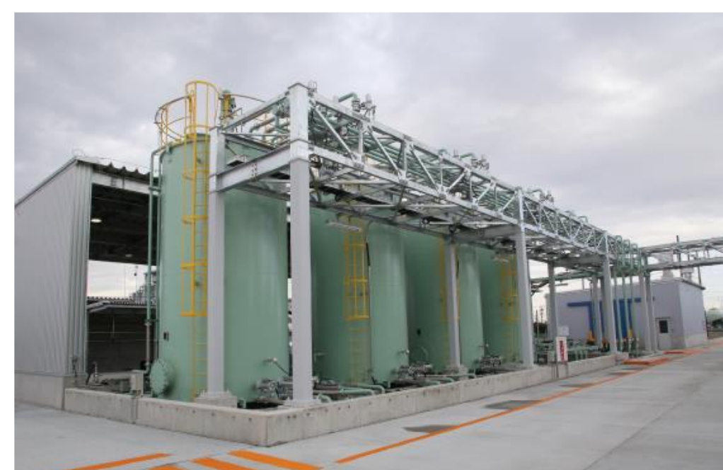
再生燃料化施設
