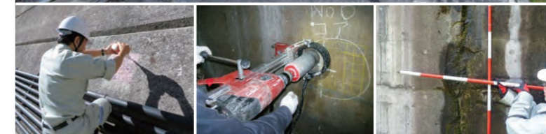
ダム点検・維持管理・長寿命化計画（左から鎌井谷ダム・矢作ダム・桐見ダム）
