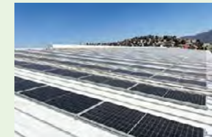
分散型電源事業 (メキシコ: 屋根置き型太陽光発電システム)
