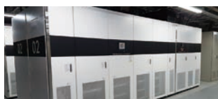
受変電システム(UPS)
