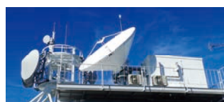
防災・通信システム(無線伝送システム)
