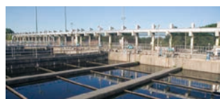
上下水道システム
