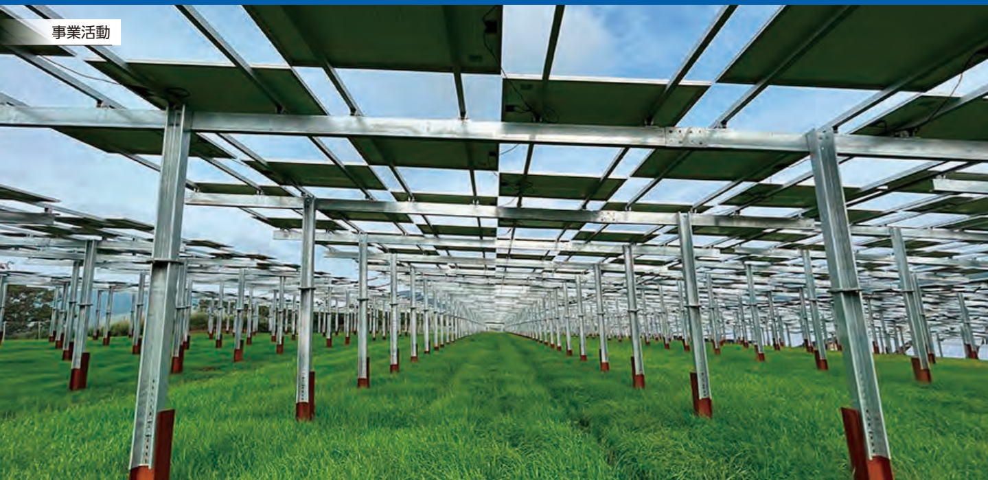
熊本小国営農型太陽光発電所 (熊本県小国町)
