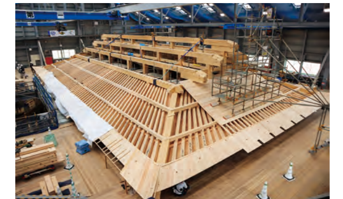
首里城正殿復元整備工事（沖縄県那覇市） 小屋（屋根内部）を構成する木材の建て方が進む素屋根の中 ※ 写真は2024年3月時点
