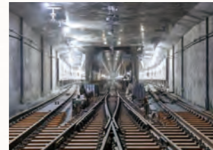
2024 相鉄・東急新横浜線、新横浜駅他 デジタルツールをフル活用し、生産 性向上を図るとともに、施工管理 の効率化・高度化を実現
