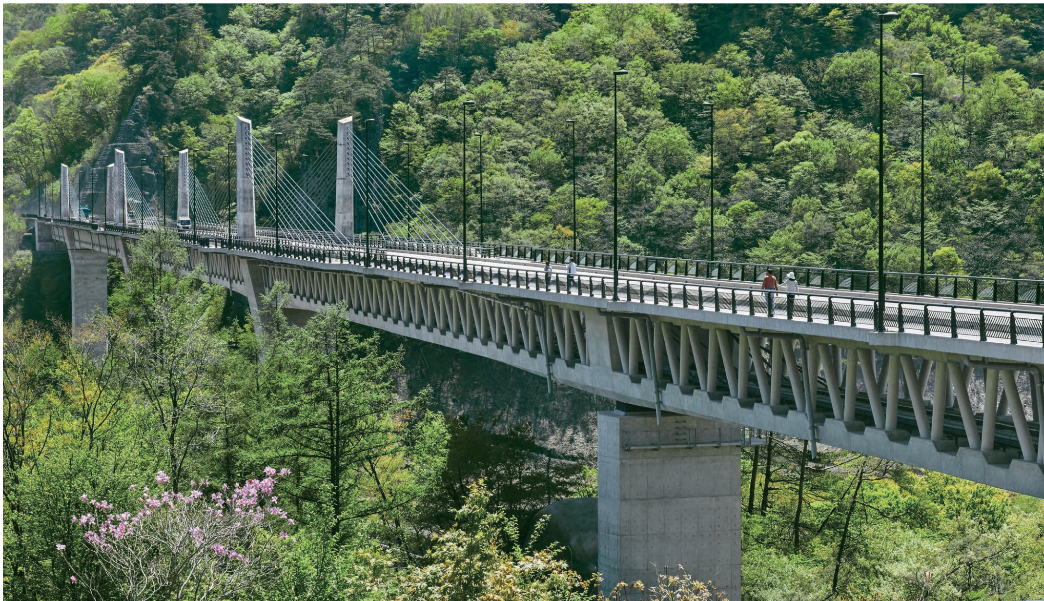
不動大橋(群馬県吾妻郡長野原町) 2011年竣工 平成22年度土木学会田中賞(作品部門)受賞 発注者:国土交通省 関東地方整備局 八ッ場ダム工事事務所
