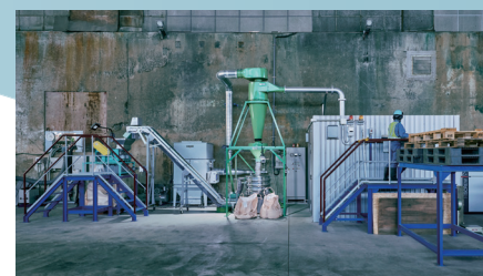
エコシステム花岡の使用済み太陽光パネル処理設備
