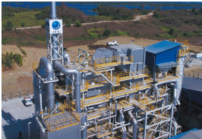
経済成長に伴うごみの増加と電力不足の課題を解消する ミャンマー初の廃棄物発電プラント
