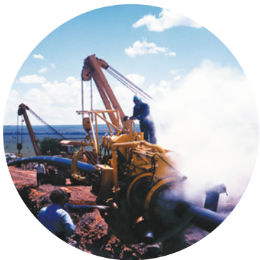
ケニアパイプライン (1978)
