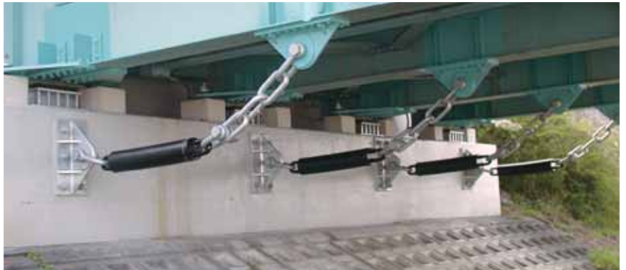
落橋防止システム (緩衝チェーン)
