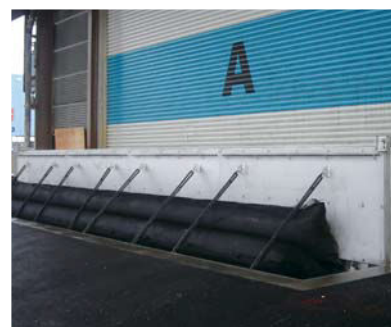
止水板・防水扉
