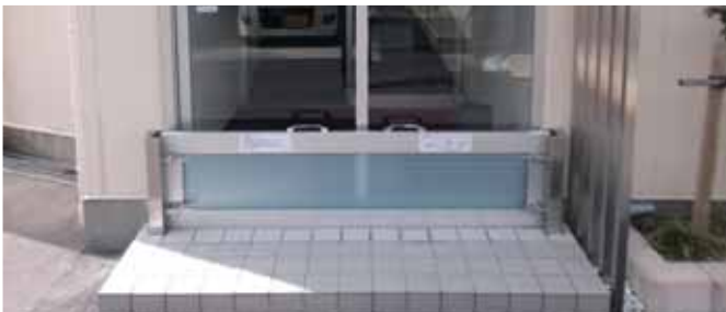
止水板・防水扉
