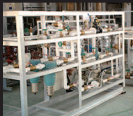
溶解槽燃焼配管ユニット Burning Unit of Melter
