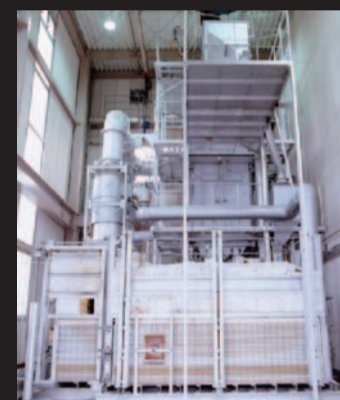
カレット予熱機 Cullet Preheater
