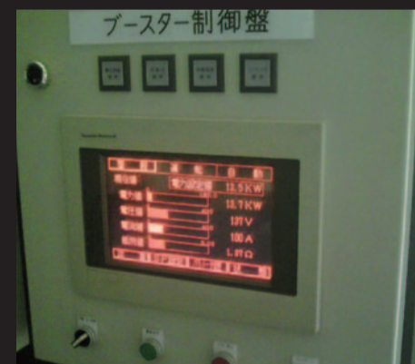
ブースター制御盤 Control Panel for Boosting
