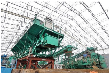
洗浄設備の外観
