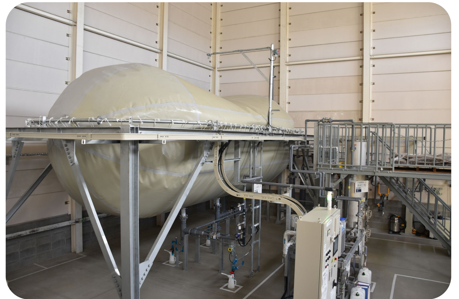
バイオガスを貯めるガスバッグ
