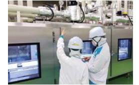
工場にて生産設備を保守点検中
