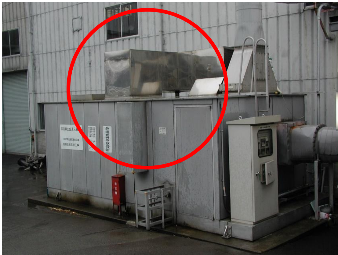
排煙装置外観
