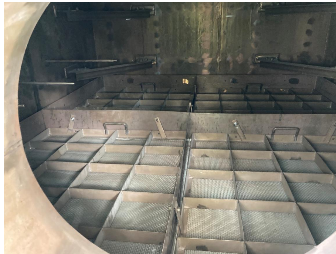
排煙装置内部
